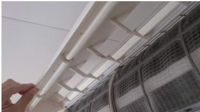
Fig. 4. viser teipprøve 1. som er tatt inne i varmepumpa
