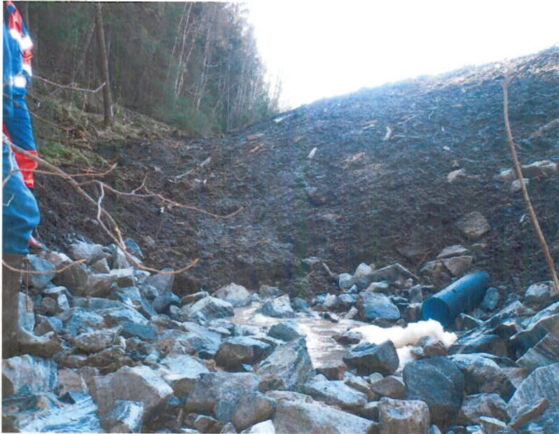
Figur 2 Utløpet av drenerørret fra området NØ for avfallsplassen. Planerte masser har fylt opp deler av det gamle bekkeløpet inn mot skogen.
